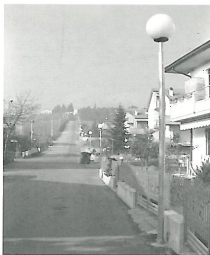
Impianto pubblica illuminazione Borgo Massano
